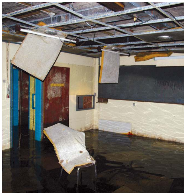
■ Bunkeren eksisterer stadig ved brandstationen i Bramming, men er beskadiget af indtrængende vand.
